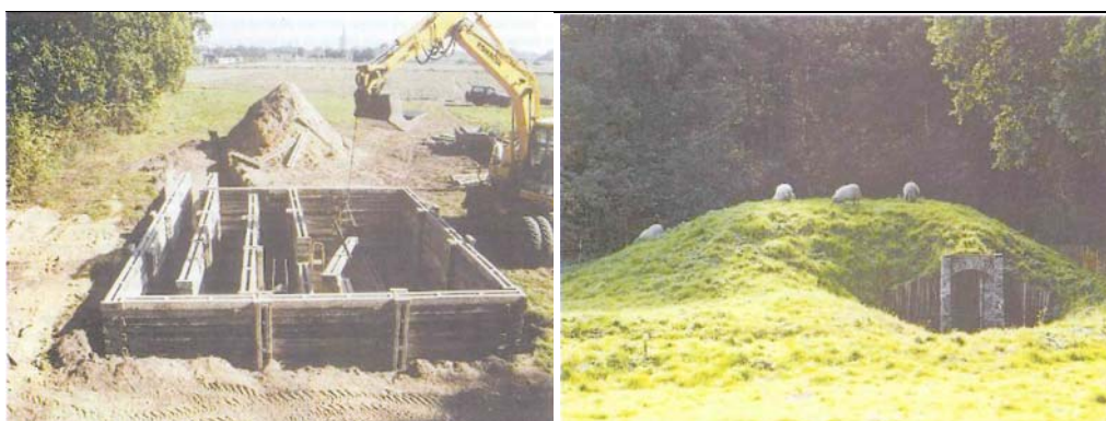
Figuur 3.27 Potentiële ondergrondse winterverblijfplaats
