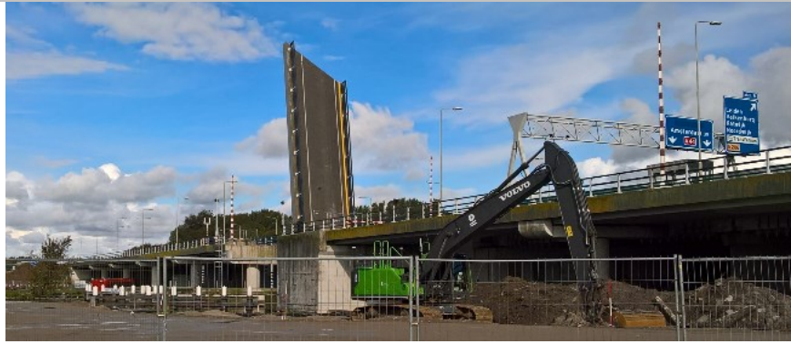
Het val van de busbrug staat al verticaal.
